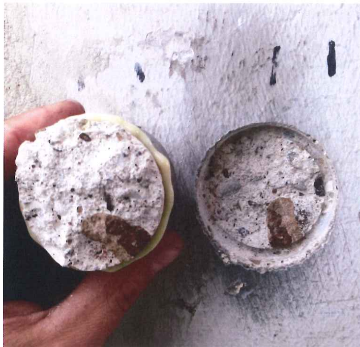
Abbildung 40: Exemplarische Ansicht einer Oberflächenzugfestigkeitsprüfung an einer Stütze (OZ 1), hier Kohäsionsversagen im Beton
