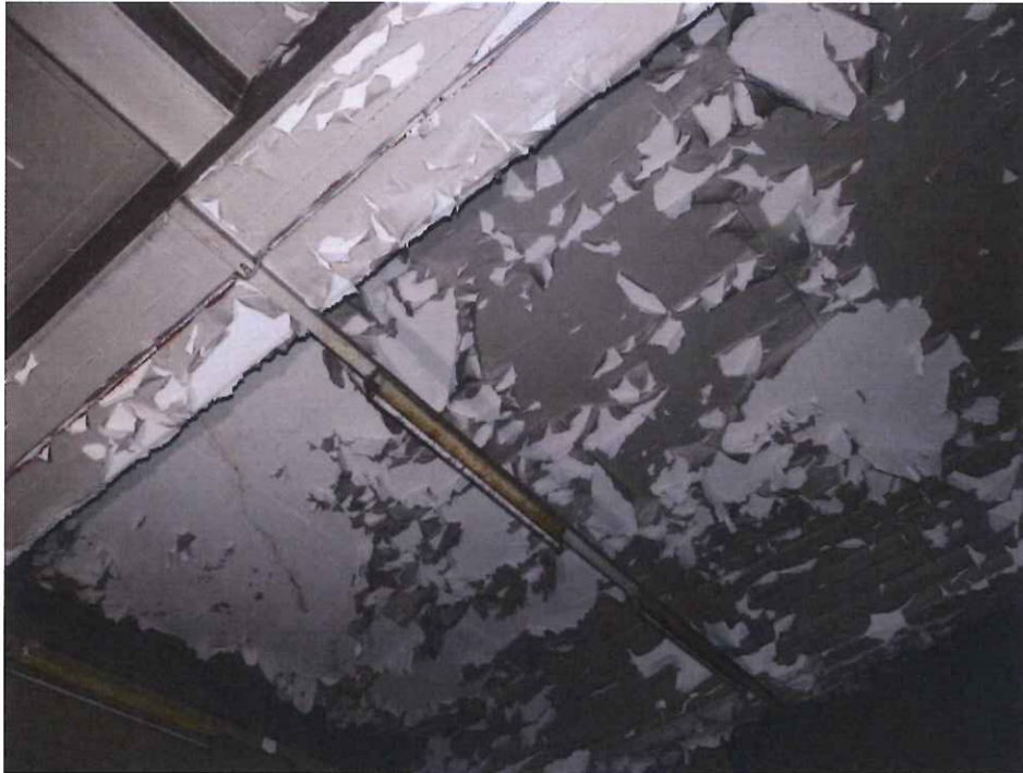
Abbildung 27: Exemplarische Ansicht der flächig abgeblätterten Beschichtung an Unterzügen und Deckenunterseite (Bühne 11)
