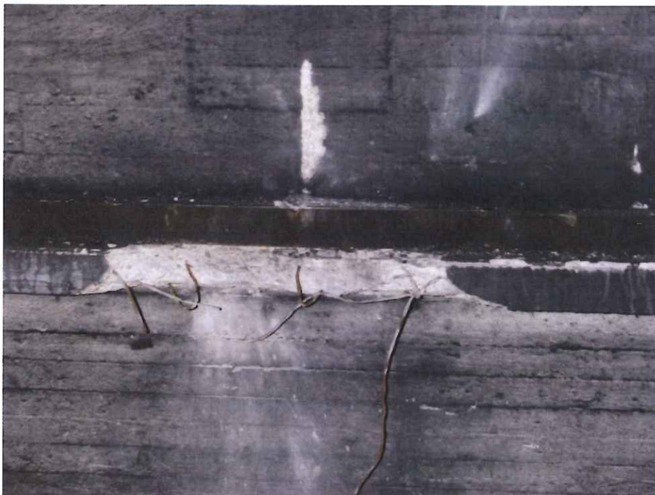
Abbildung 30: Detailansicht zu Abbildung 29; durchtrennte Bewehrung
