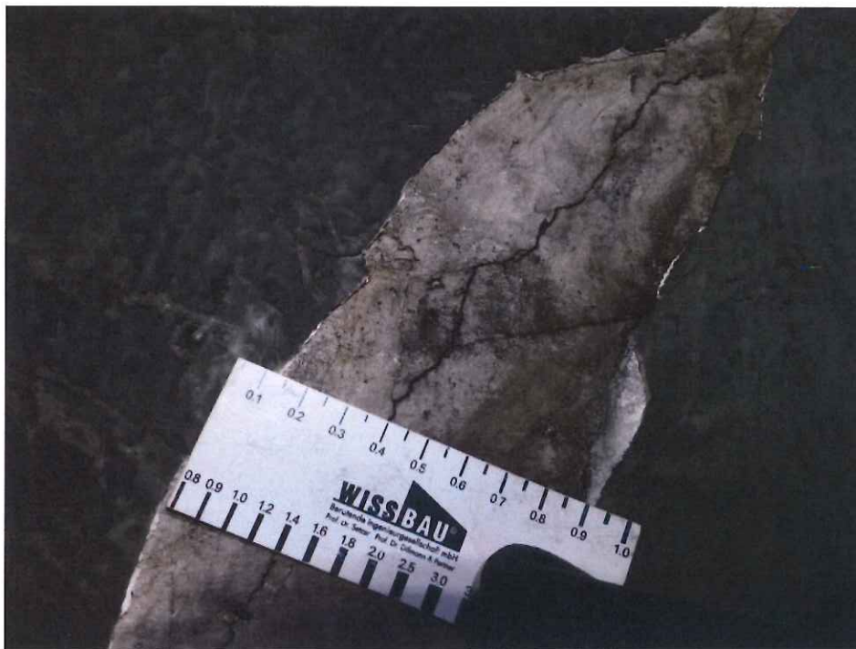
Abbildung 26: Detailansicht zu Abbildung 25, hier Rissbreite 0,4
