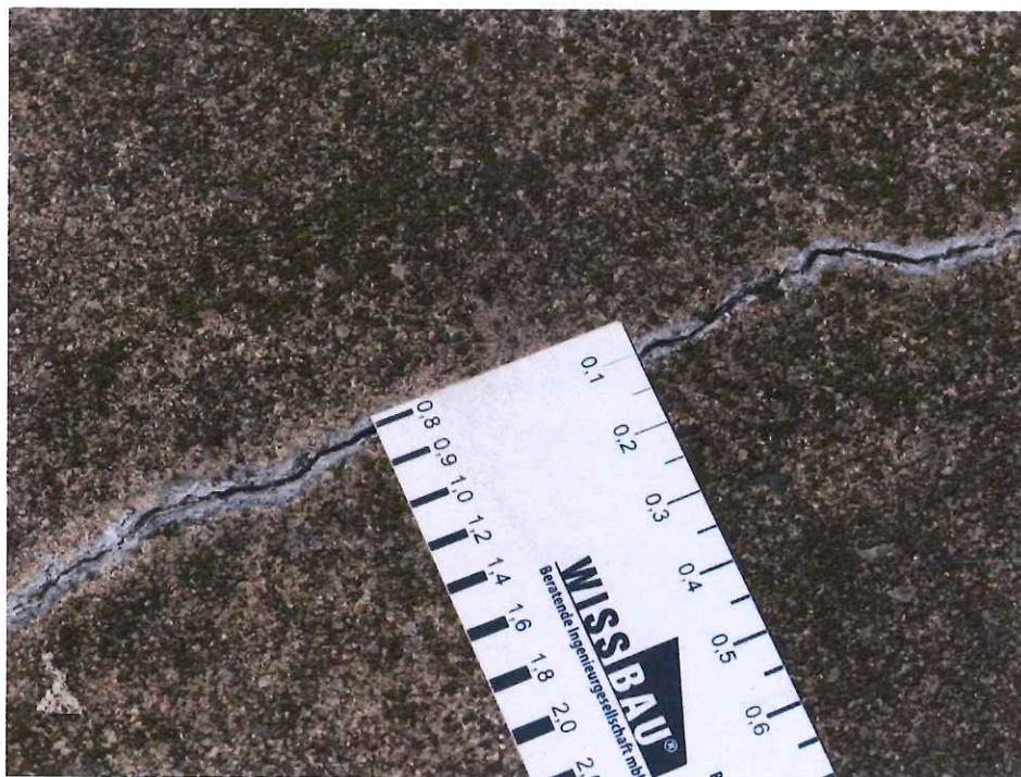
Abbildung 19: Detailaufnahme zu Abbildung 18, hier Rissbreite 0,8 mm
