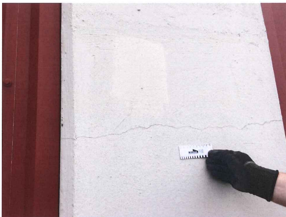
Abbildung 14: Exemplarische Ansicht eines über die Bauteilbreite horizontal verlaufenden Risses an einer Stahlbetonstütze an der Westseite; Rissbreite 0,2 mm
