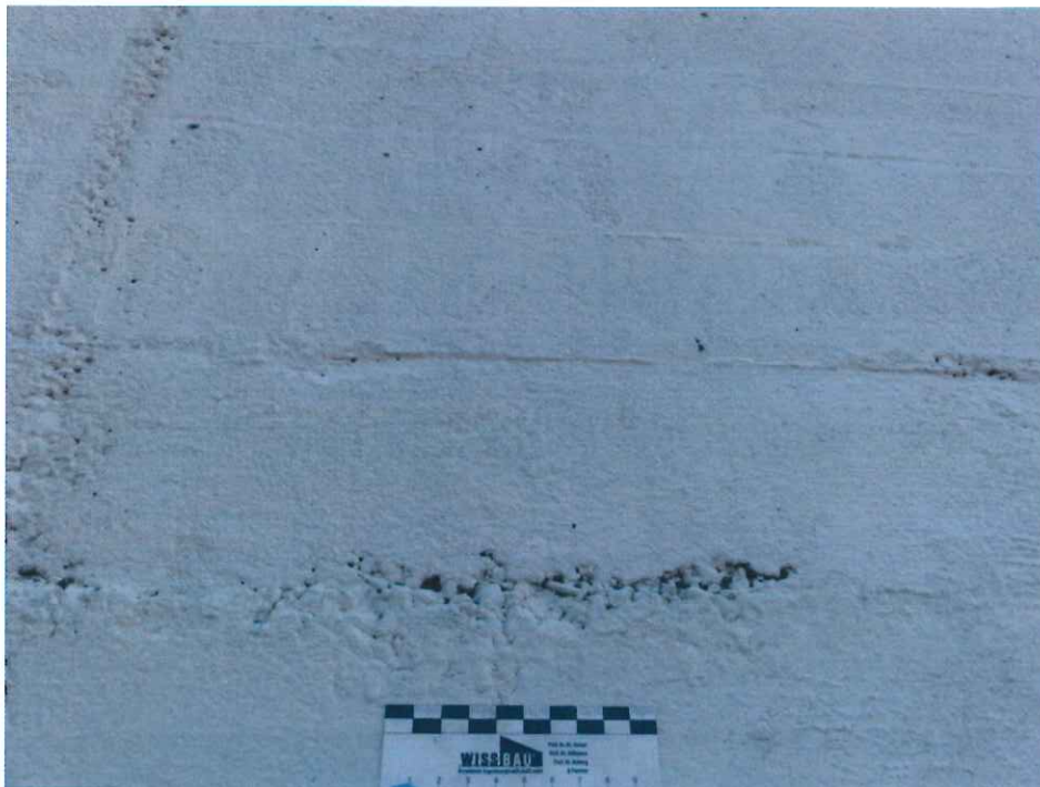
Abbildung 21: Exemplarische Ansicht von Gefügestörungen in der Betonoberfläche auf der Westseite der Galerie
