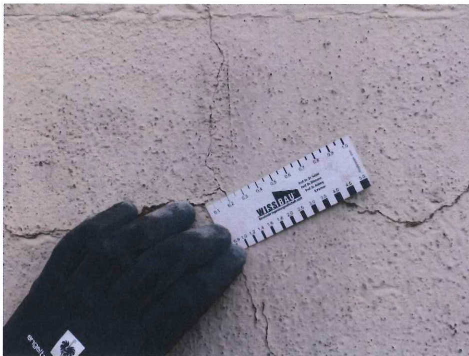
Abbildung 13: Detailansicht zu Abbildung 12; Rissbreite Längsriss hier 0,2 mm
