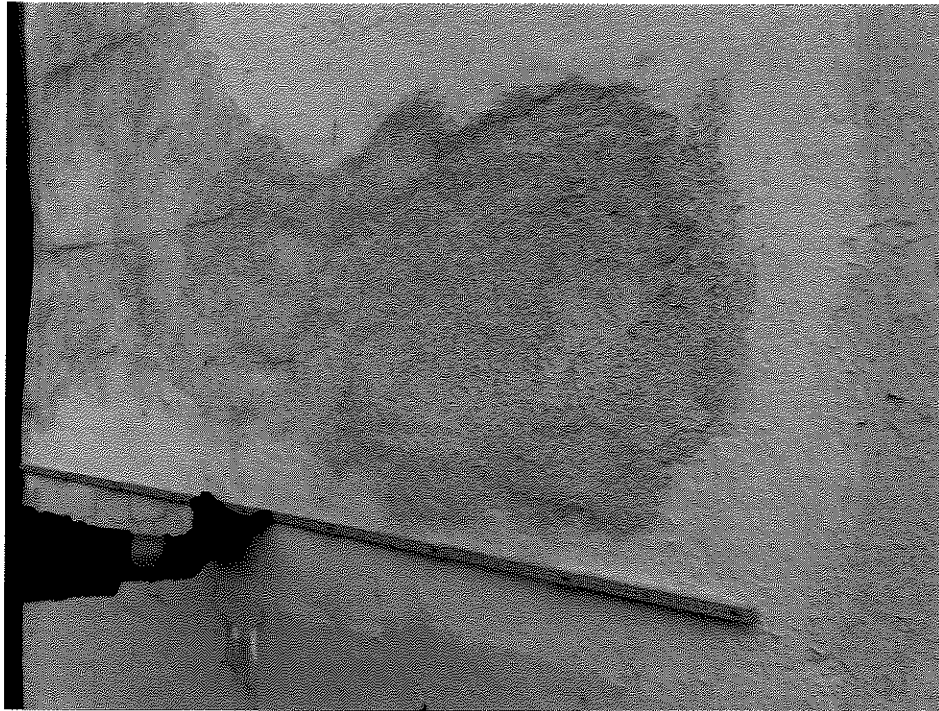
Abbildung 10: Exemplarische Ansicht einer nicht fachgerechten reprofilierten Stelle an einer Stahlbetonstütze an der Westseite (außen)
