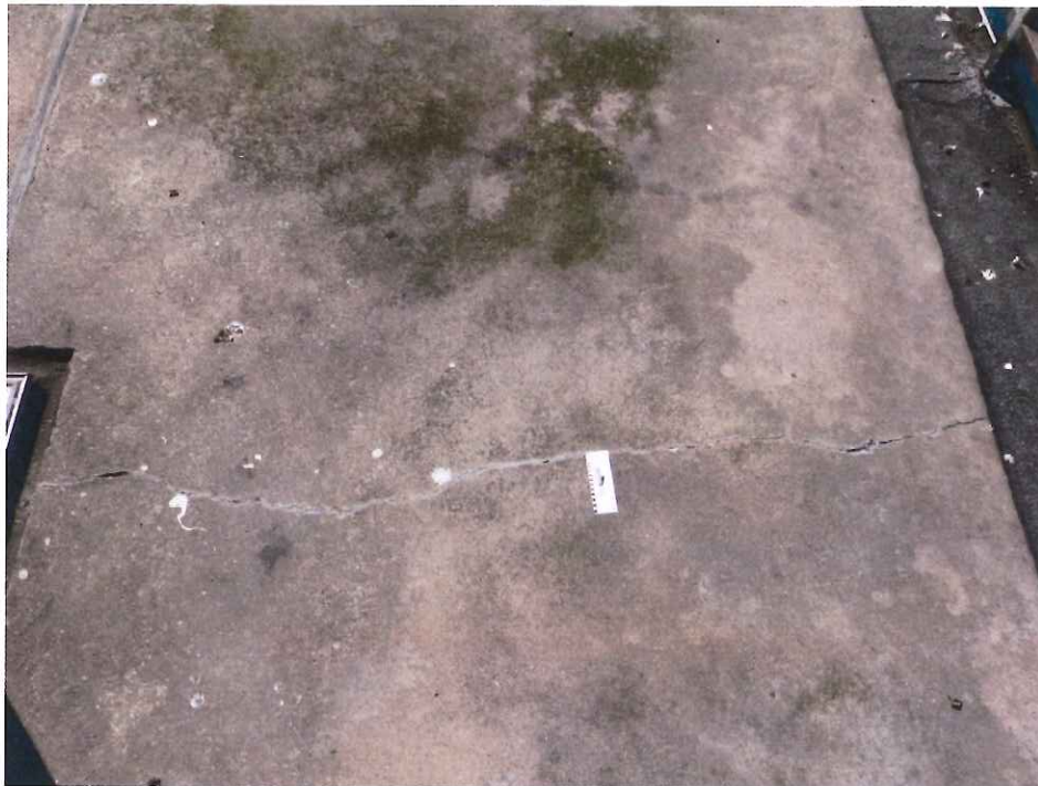
Abbildung 18: Exemplarische Ansicht eines Risses auf der Laufplattenoberseite im Estrich der Galerie (Westseite)
