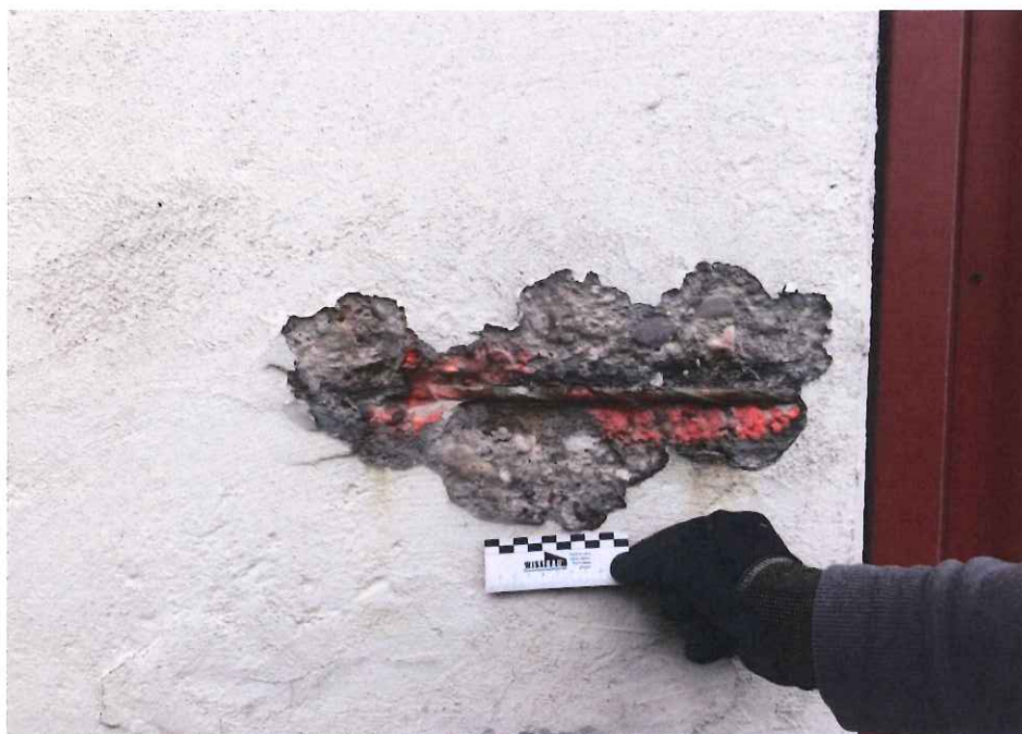
Abbildung 15: Exemplarische Ansicht korrosionsbedingter Betonabplatzung mit freiliegender korrodierter Bügelbewehrung und Reste eines Korrosionsschutzanstrichs an der Ostseite
