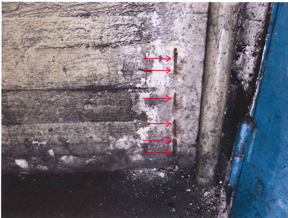
Abbildung 32: Exemplarische Ansicht freiliegender korrodierter Bewehrung im Treppenhaus 1
