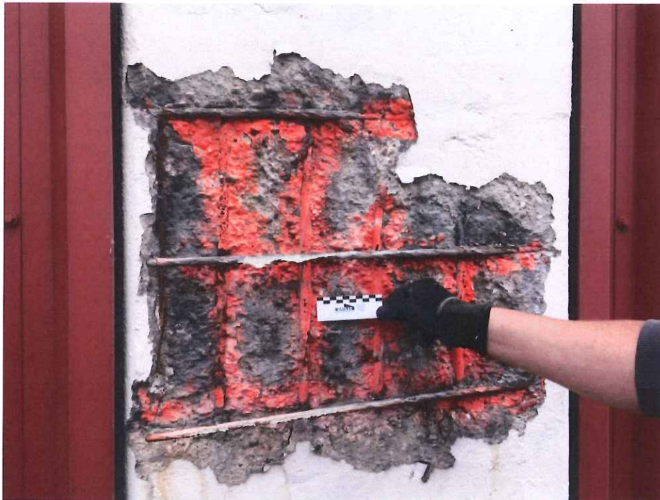
Abbildung 16: Weitere exemplarische Ansicht freiliegender, korrodierter Längs- und Bügelbewehrung und Reste eines Korrosionsschutzanstrichs an der Ostseite
