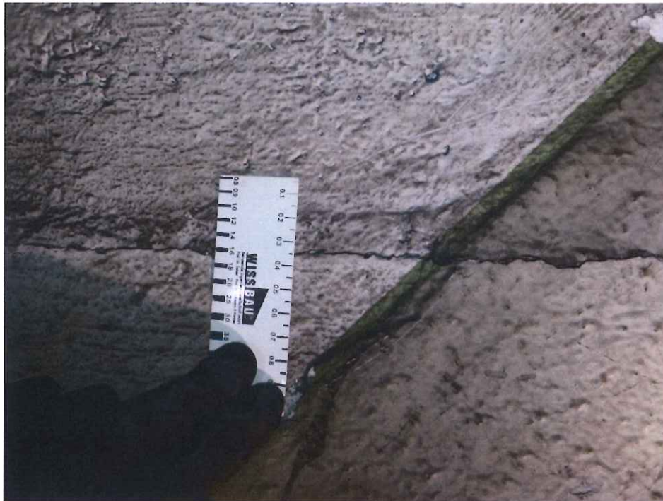
Abbildung 23: Detail Ansicht zu Abbildung 22, hier Rissbreite 0,35 mm
