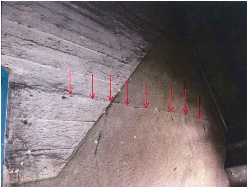
Abbildung 22: Exemplarische Ansicht eines horizontal verlaufenden Risses an der Wand im Treppenhaus 12, voraussichtlich eine Arbeits- oder Betonierfuge
