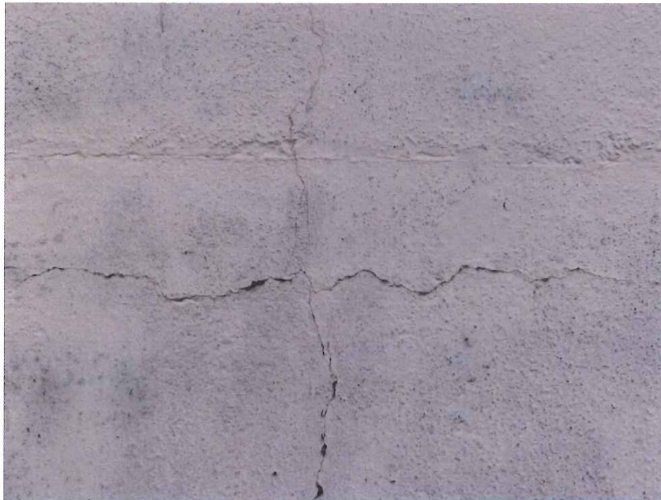
Abbildung 12: Exemplarische Ansicht von längs- und querlaufenden Rissen in der Beschichtung einer Stahlbetonstütze, die sich kreuzen (Westseite)
