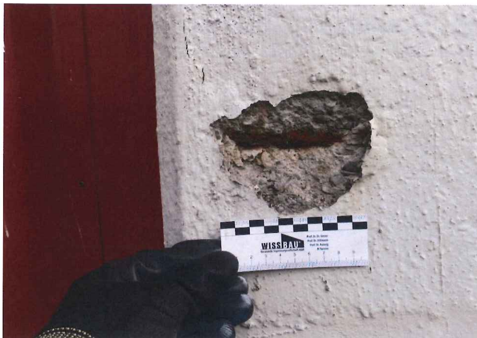
Abbildung 17: Exemplarische Teilansicht einer korrosionsbedingten Betonabplatzung mit freiliegender korrodierter Bewehrung an der Südseite (außen)
