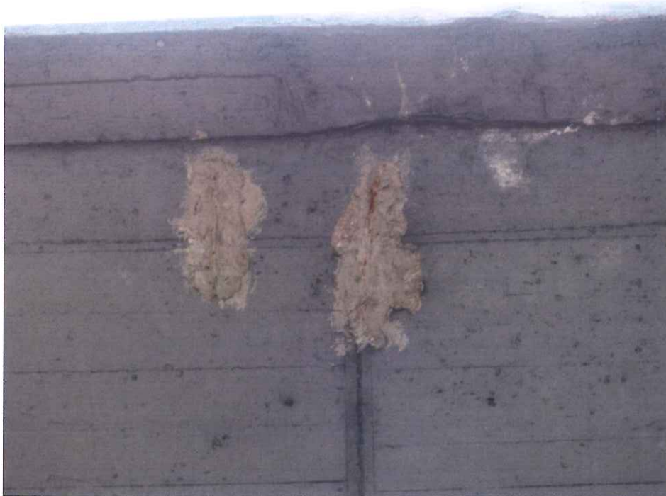
Abbildung 20: Exemplarische Ansicht der Laufplattenunterseite der Galerie mit Minderbetondeckung und Abplatzungen mit freiliegender Bewehrung (Westseite)
