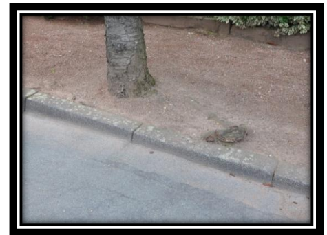
Der Wurzelraum ist zum Teil stark verdichtet.
